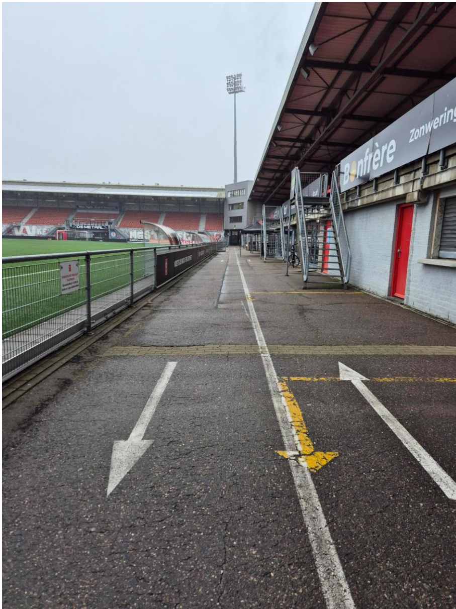
Foto III: De scheuren in de gracht
